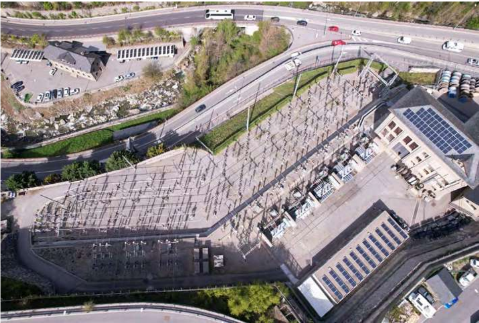
Instal·lacions fotovoltaïques a l'ETR d'Encamp.
